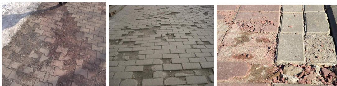
Рисунок 23 - Фрагменты разрушения тротуаров, устроенных из бетонных брусчаток.
