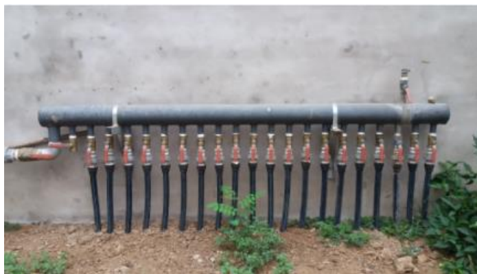
Рисунок 2 – Выходы спирального теплообменника к тепловому насосу.
