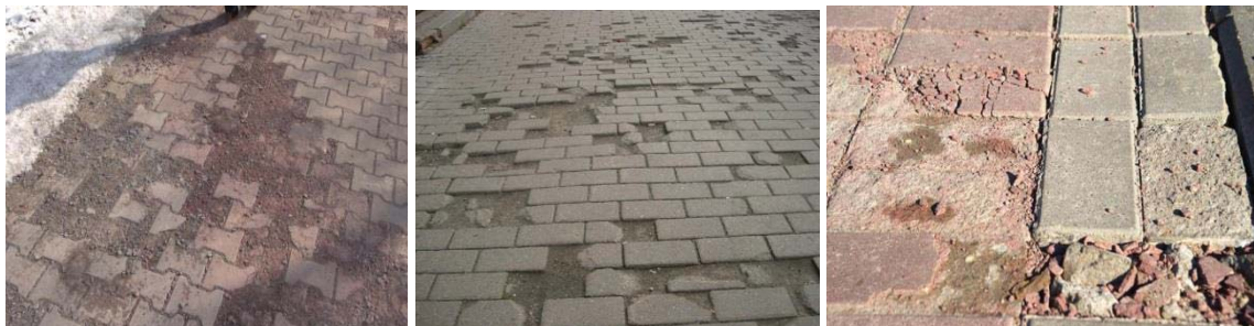
Рисунок 1. Фрагменты разрушения тротуаров, устроенных из бетонных брусчаток.
